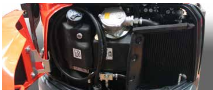
Pompa elettrica riempimento gasolio
